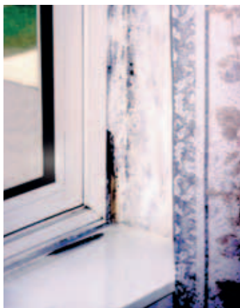
Поражения плесневым грибом в откосе оконного проёма
