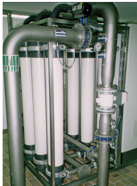
Abb. 1: moderne Wasseraufbereitung mittels Ultrafiltration
